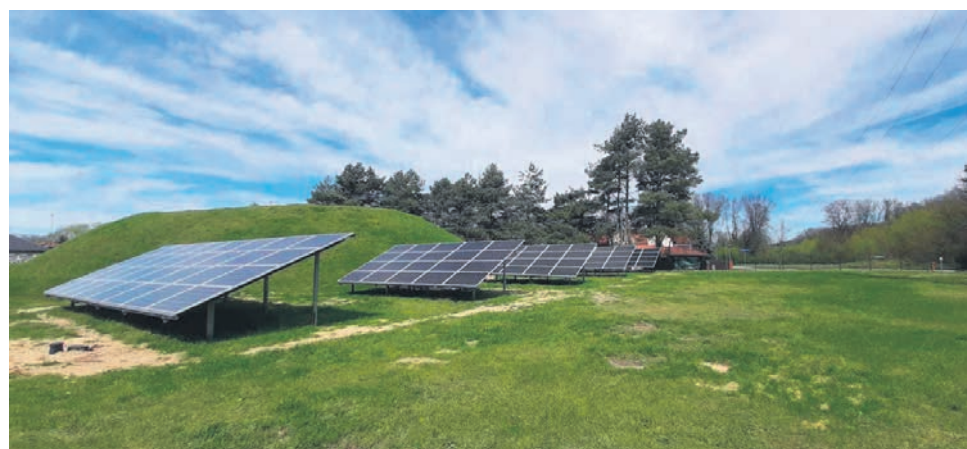
SUW Karczma Borowa – mikroinstalacja fotowoltaiczna - 2021 rok
