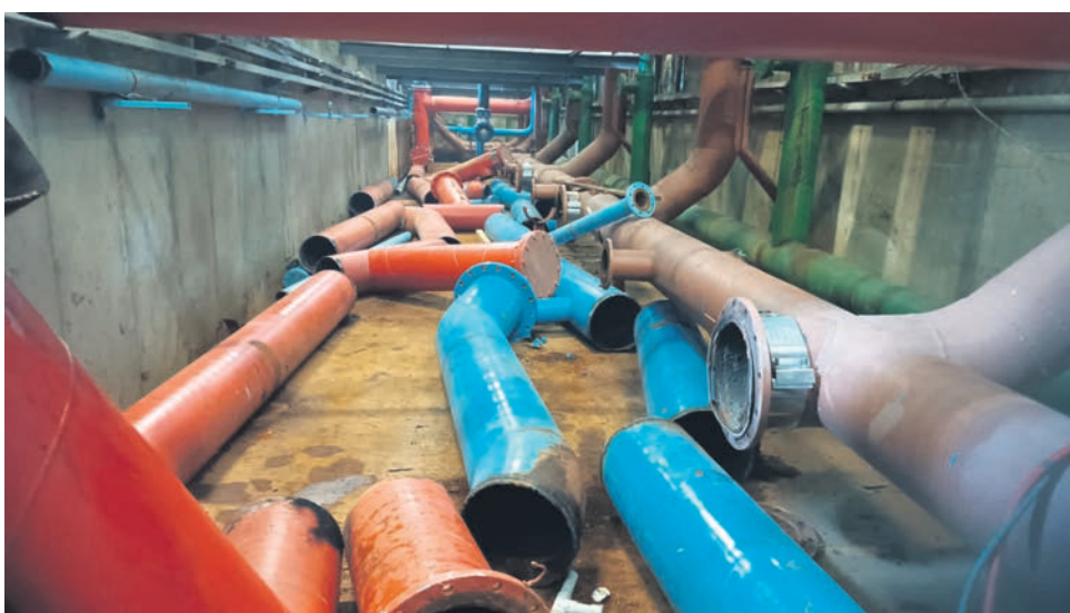
Skorodowane rurociągi w kanale technologicznym
