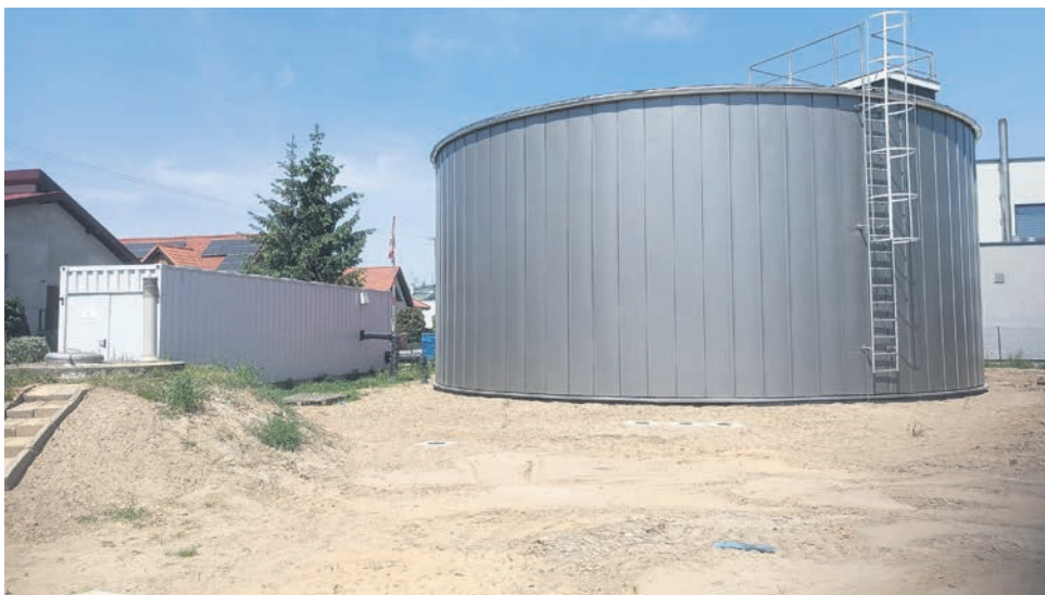
Zbiornik wody czystej w Lipnie o pojemności 500m 3
