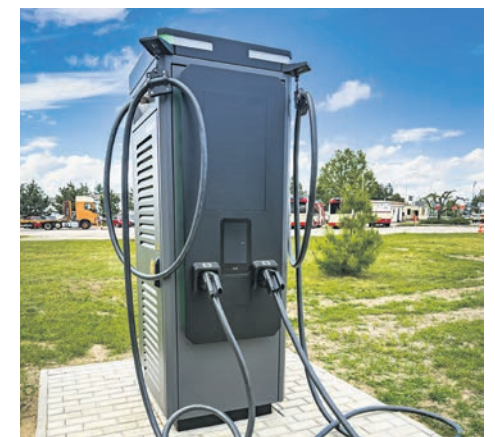
W zakładzie zainstalowano ładowarki. Pojazdy będą ładować się przede wszystkim nocą
